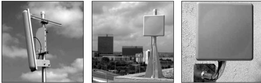
Figura 3.13 Estaciones base. Acceso fijo inalámbrico en banda ancha
