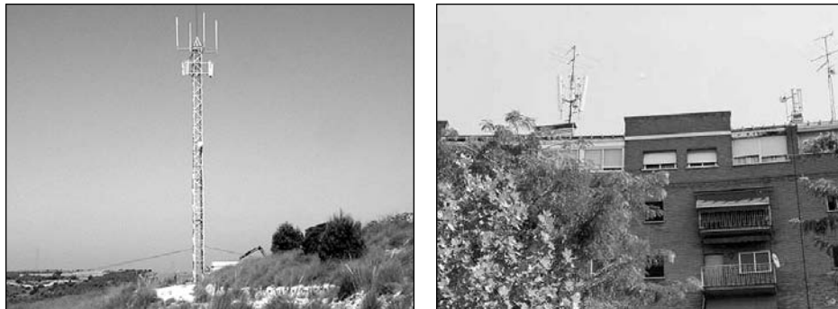
Figura 3.2 Estaciones base rural y urbana
